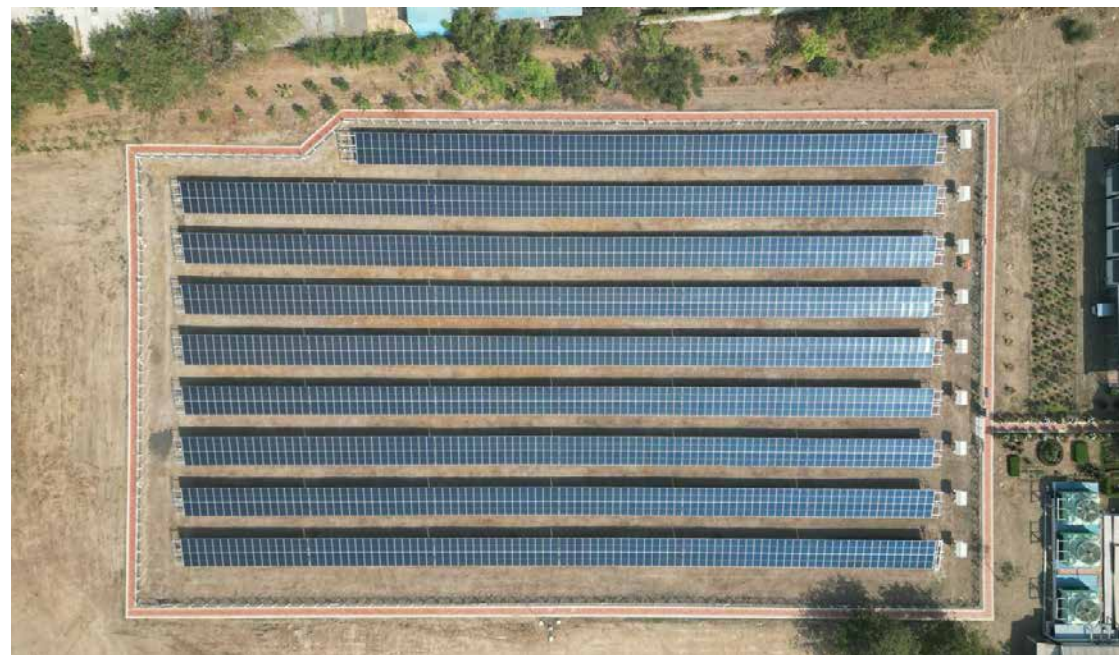
Photovoltaik-Anlage am MAN ES Standort in Aurangabad (Indien)
