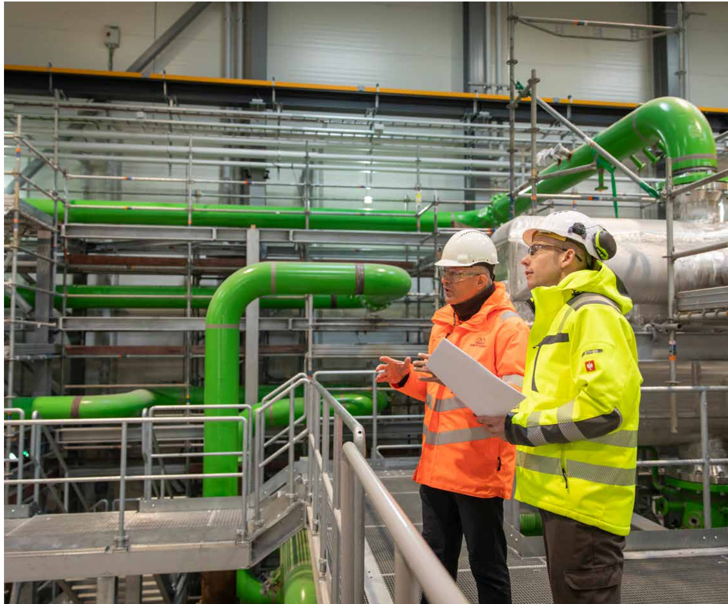
MAN ES Wärmepumpe zur Versorgung der dänischen Stadt Esbjerg
