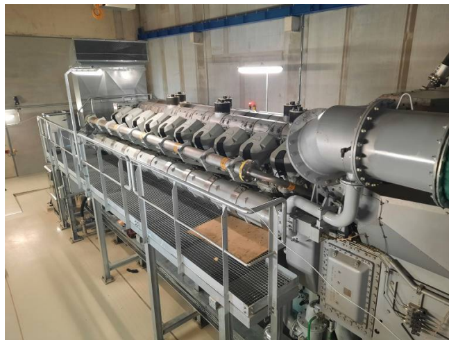
Das Heizkraftwerk wird von fünf MAN 20V35/44G Gasmotoren betrieben ©Stadtwerke Frankfurt (Oder)
