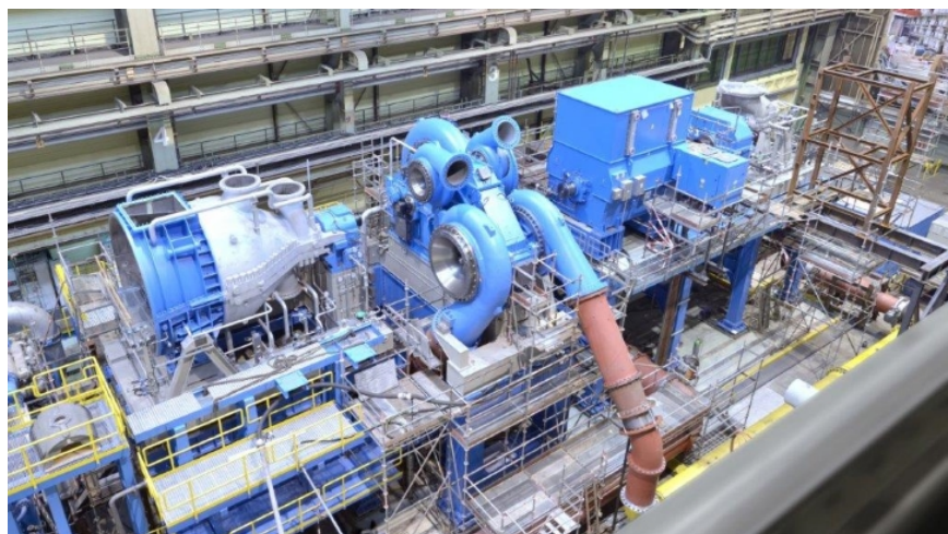
PTA-Maschinenstrang von MAN Energy Solutions
