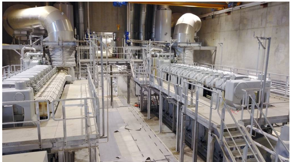
Vier MAN 9L51/60 Motoren erweitern die Gesamtleistung des Kraftwerks um 37 MW und sichern als Teil eines hybriden Energiesystems die Stromversorgung der Inseln.
